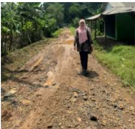
Gambar 2. Kondisi Jalan Utama Desa (Antar Dusun)
