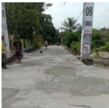
Gambar 3. Produk Jalan Hasil Pengecoran di Desa Berumbung Baru, Kecamatan Dayun, Kabupaten Siak sejauh 1 KM
